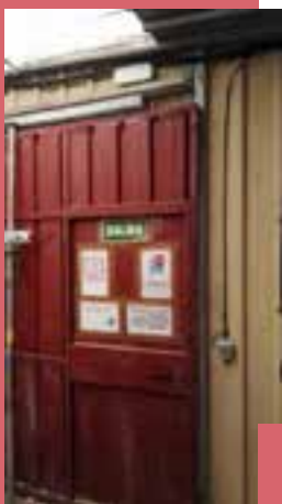
Figura 3. Iluminación de emergencia en puerta de salida
